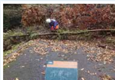
倒木伐採撤去
