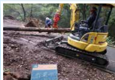
倒木伐採撤去
