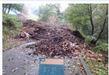
法面崩壊現場
