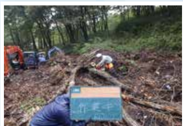
倒木伐採撤去
